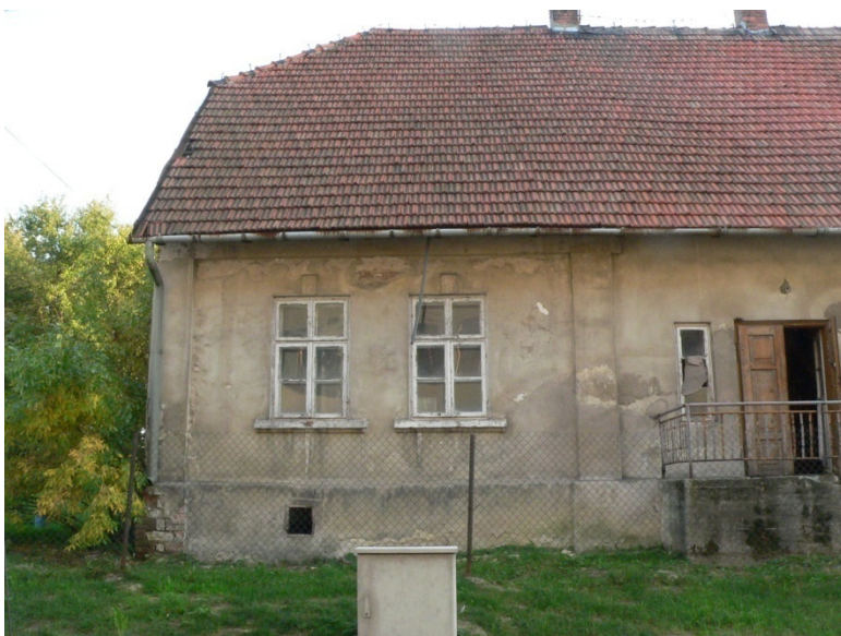
Widok elewacji północnej widoczne zawilgocenie murów na elewacji.
