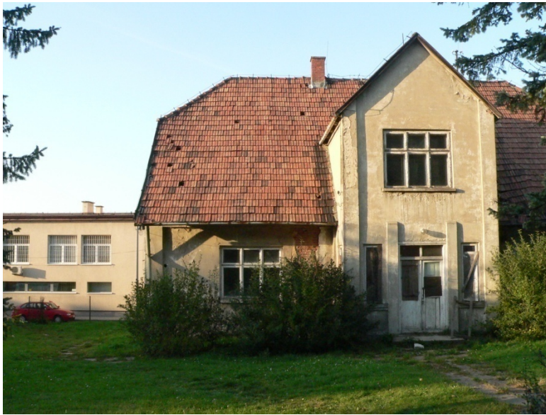
Widok elewacji południowej Widoczne ubytki w poszyciu dachowym.
