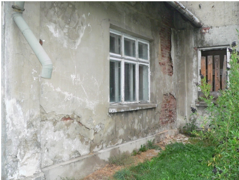
Widoczne zawilgocenie i odpadający tynk na ścianach zewnętrznych, zły stan techniczny stolarki okiennej.
